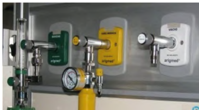
Imagen 1. Tomas de gases (Fuente: Seisa.Med).
